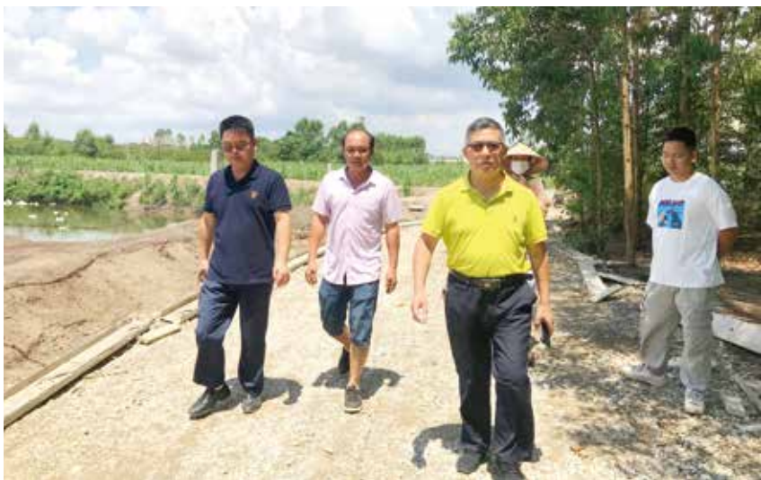
2019年7月1日,区城管交通局局长杨明功(左三)在农村道路硬底化建设现场监督施工进度 区城管交通局 供
